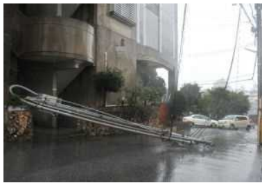
台風の強風で鉄柱が折れ倒れた電柱 =11日午後0時26分、浦添市城間
